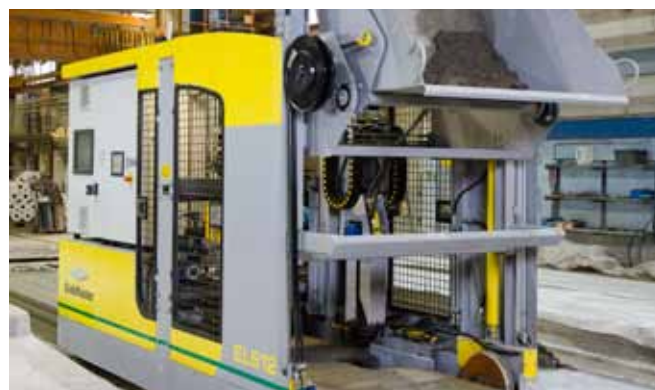
Die Maschine arbeitet am frischen Beton. Sie fährt direkt hinter dem Extruder/Gleitfertiger.
